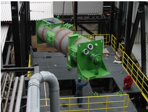
Installation eines 10m 3 Sonderabfallmischers
